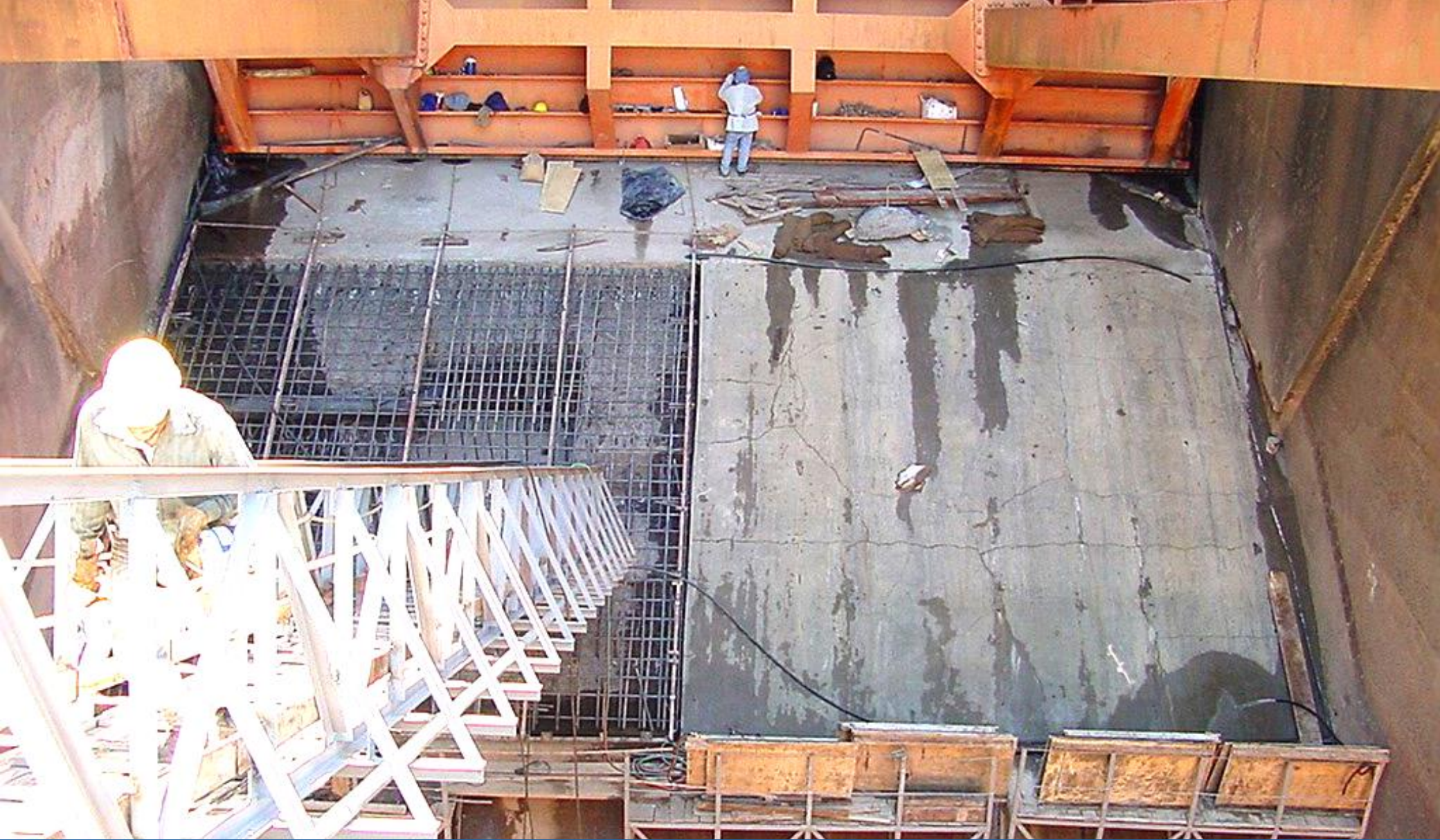
VISTA GENERAL DE FISURAS EN VANO 18
