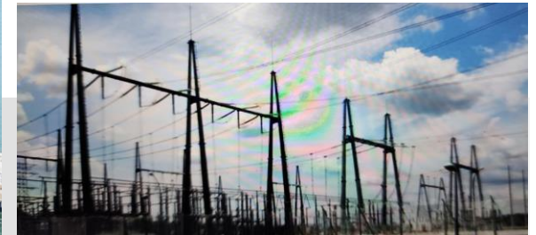
L.A.T. 500KV / E.T 500KV
