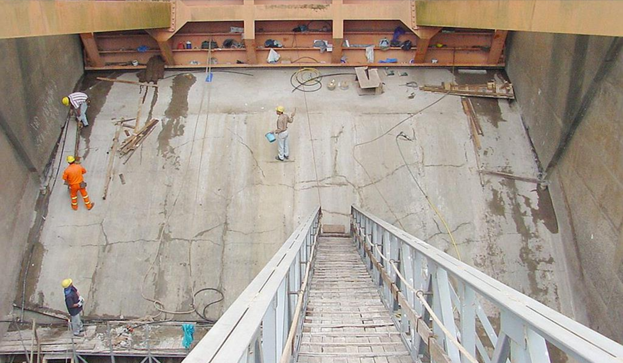
VISTA GENERAL DE FISURAS EN VANO 1
